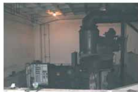
Vista General del equipo de incineración del IESS
